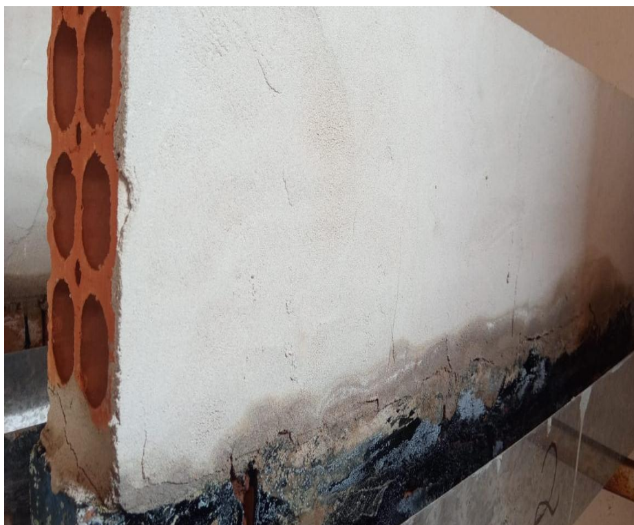
Figura 14 - Amostra 2, com o surgimento de manchas de umidade no 5º dia.
