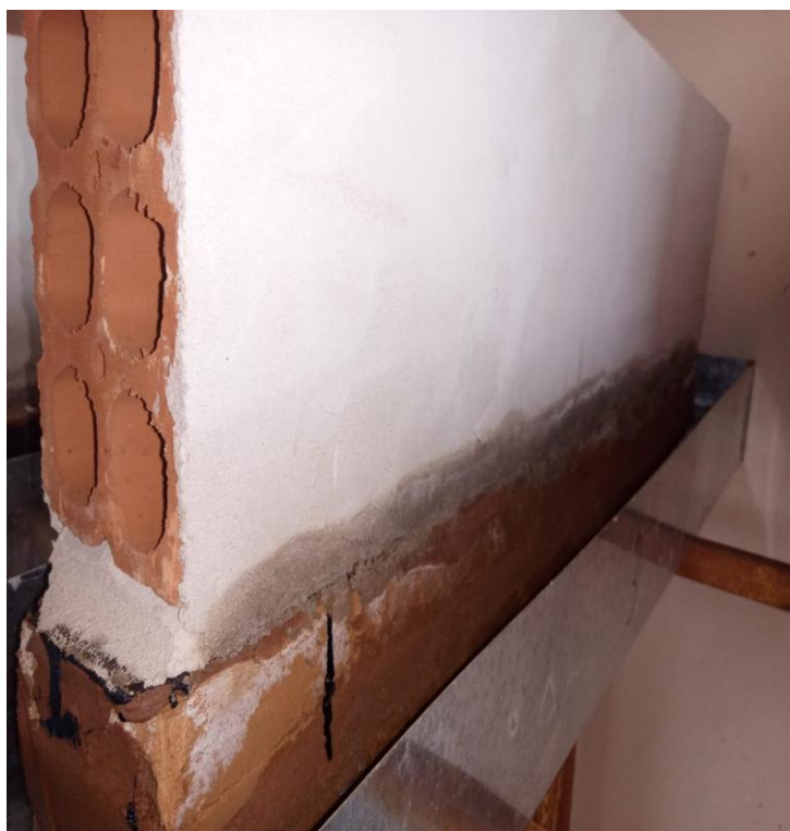
Figura 15 - Amostra 3, com o surgimento de manchas de umidade no 5º dia.
